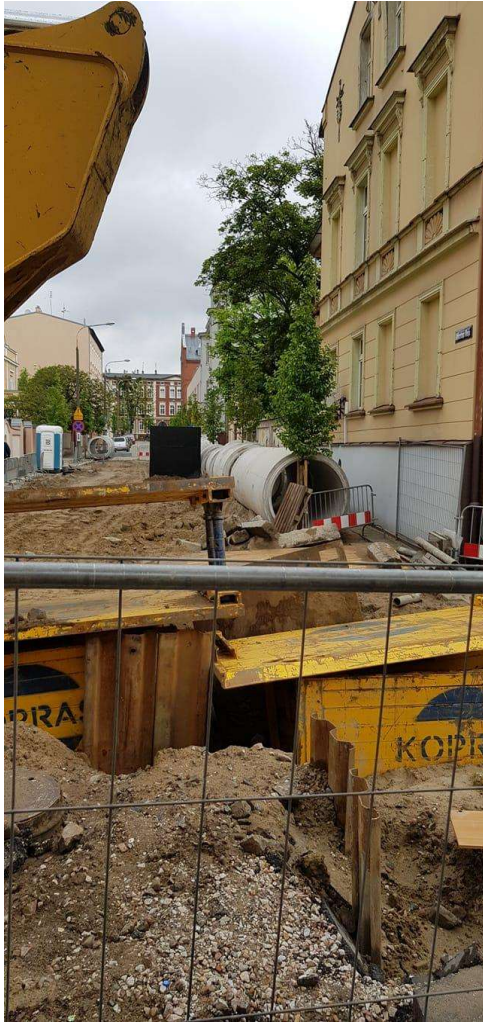
Zdj. 3. Brak zabezpieczenia drzew na ul. Reja (widok od strony ul. Skargi), źródło: modrzew.org.pl
