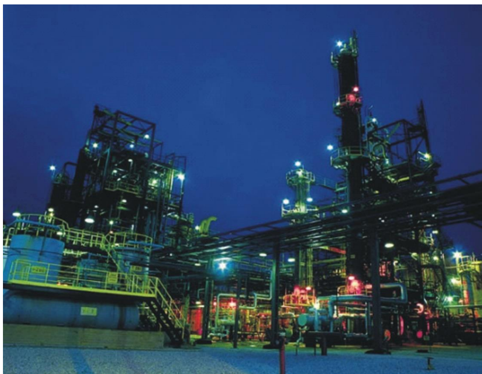
Fot. 3. Instalacja TDI/TDA w dawnych Zakładach Chemicznych „Zachem” (źródło: zachem.com.pl)
